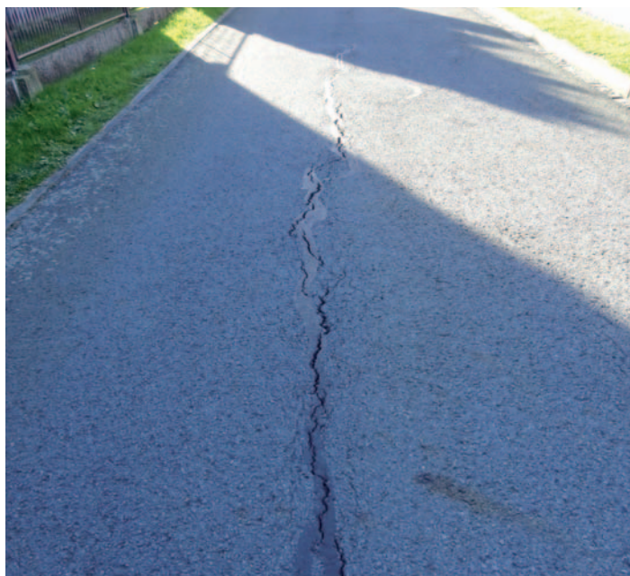
Stav komunikace před opravou
