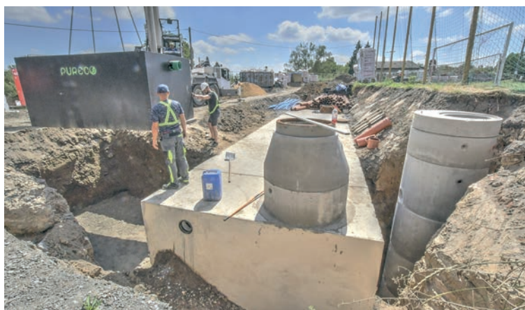
Odlučovač vod z parkoviště, retenční nádrž a čerpací stanice pro závlahu hřiště
